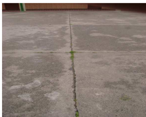
Foto 9: Rastreo de grietas en el piso por medio del bastón (caminar en línea recta)
